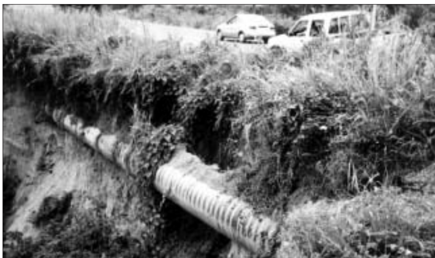
Las obras de prevención reducen la vulnerabilidad de los sistemas. Tubería expuesta, Ecuador
