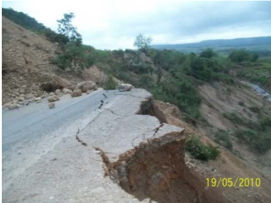
Pérdida de plataforma en la carretera Fernando Belaunde Terry -IIRSA NORTE S.A
