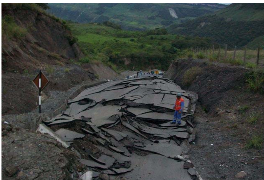
Hundimiento de calzada en la carretera
