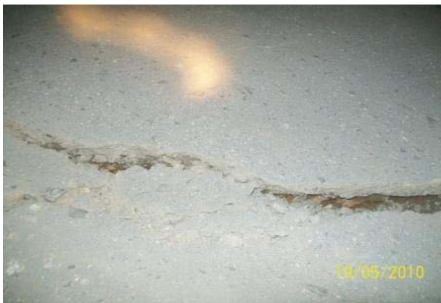
Agrietamientos en superficie asfáltica en la carretera Fernando Belaunde Terry - IIRSA NORTE S.A
