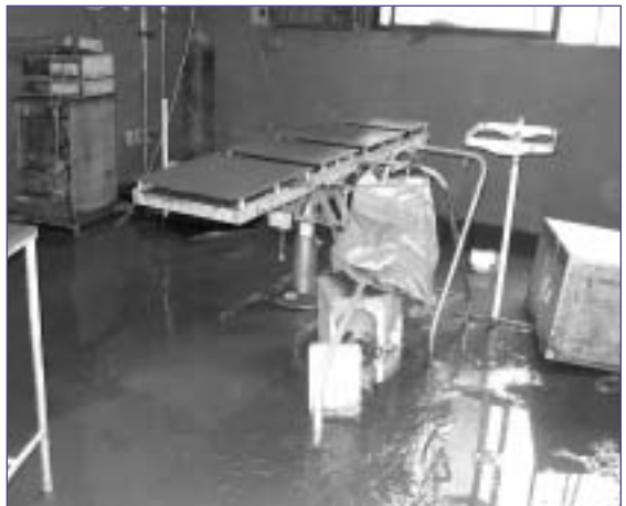
Foto 44. Quirófano dañado por inundaciones en Gonaïves, Haití. Setiembre, 2004.
